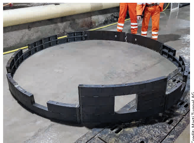
10 Liner plates utilizzati per la messa in sicurezza in L1* Liner plates used for securing L1*
