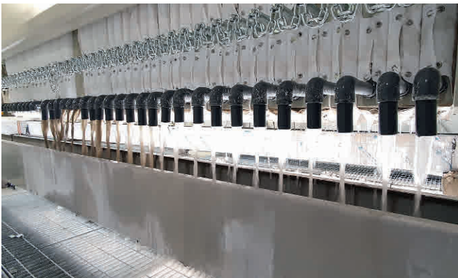
10 Installation de traitement des boues Sludge treatment plant
