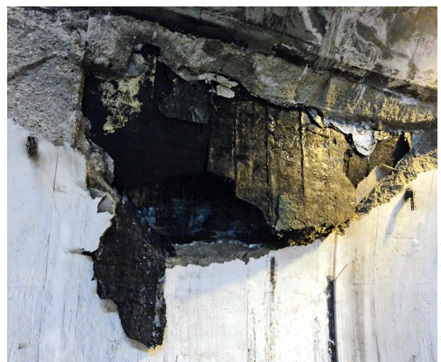
2 Niederbruch des inneren Schutzgewölbes (Foto vom 08.06.2017) Cave-in of the internal protective vault (photo dated 08.06.2017)
