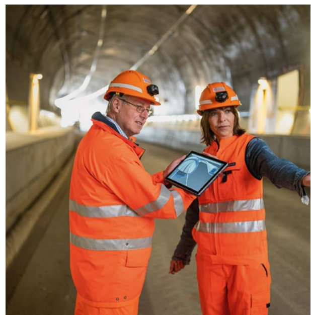
7 Digitalisierung auf der SBB-Baustelle des Bözbergtunnels Digitisation at the SBB construction site for the Bözberg tunnel
