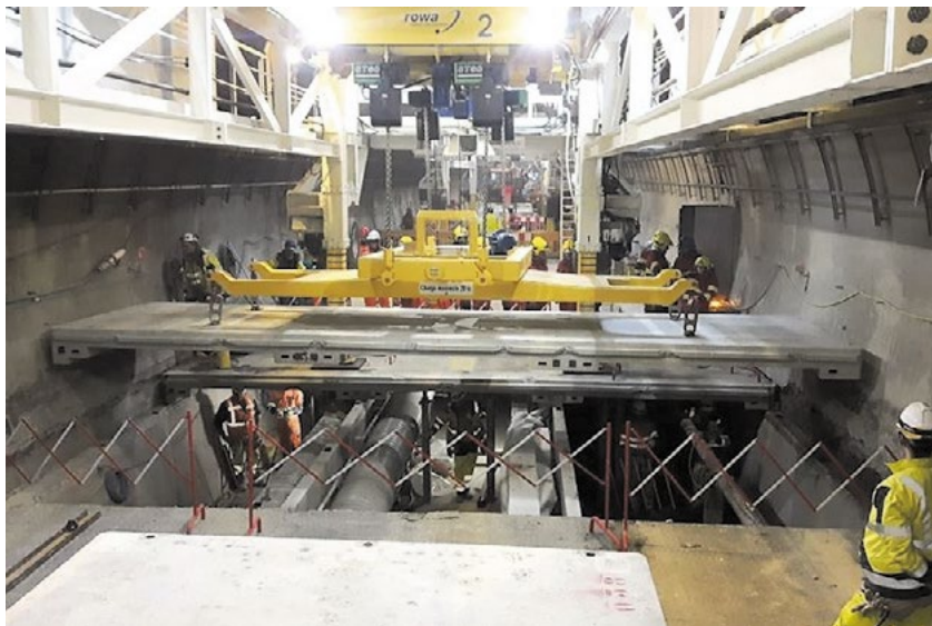
Tunnel du Mont Blanc (France / Italia) Sanierung der Fahrbahn mittels vorgefertigter Betonelemente Einsatz von zwei fahrenden Portalkränen während Nachtsperren
