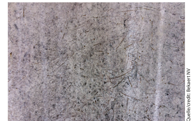
7 Oberfläche Tübbing, mehrjährig der Witterung ausgesetzt, bewehrt mit nicht galvanisierter Stahlfaser Segmental lining surface, exposed outdoors for several years, reinforced with non-zinc-plated steel fibre
