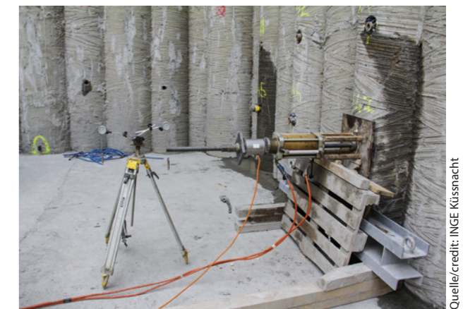
6 Ausziehversuch nach SIA 267/1. Die GFK-Anker wurden mit einem Stahlzylinder verbunden, welcher mit einer Gewindestange verbunden war Pull-out test in accordance with SIA267/1; the GRP bolts were connected with a steel cylinder which was connected to a threaded rod
