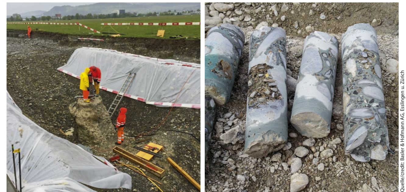
10a/b Jetting-Vorversuche mit Freilegen der Jettingsäulen/Entnahme von Bohrkernen Preliminary jet-grouting tests, including exposure of the jet-grouting columns / taking of core drillings
