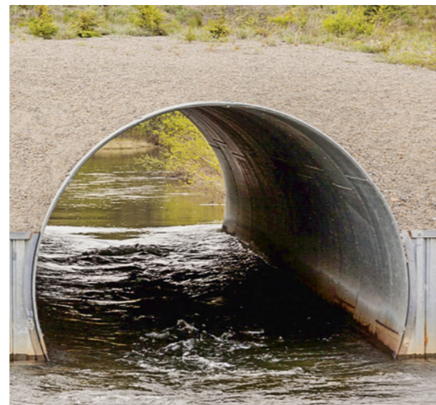
5 Exemple d'un conduit métallique avant réparation Example of a metal culvert prior to being repaired
