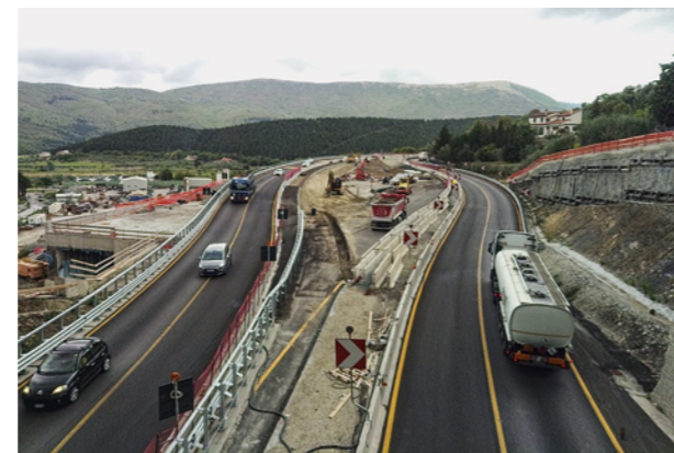
3 Deviazione esterna delle due carreggiate e realizzazione dei pali nella tratta centrale
