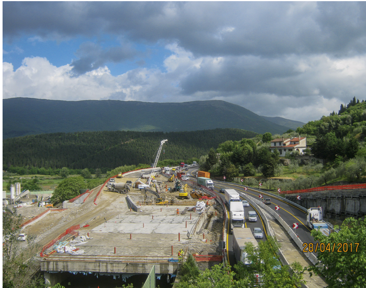
2 Deviazione a Est delle due carreggiate e del solettone Eastward deviation of the two lanes and of the slab
