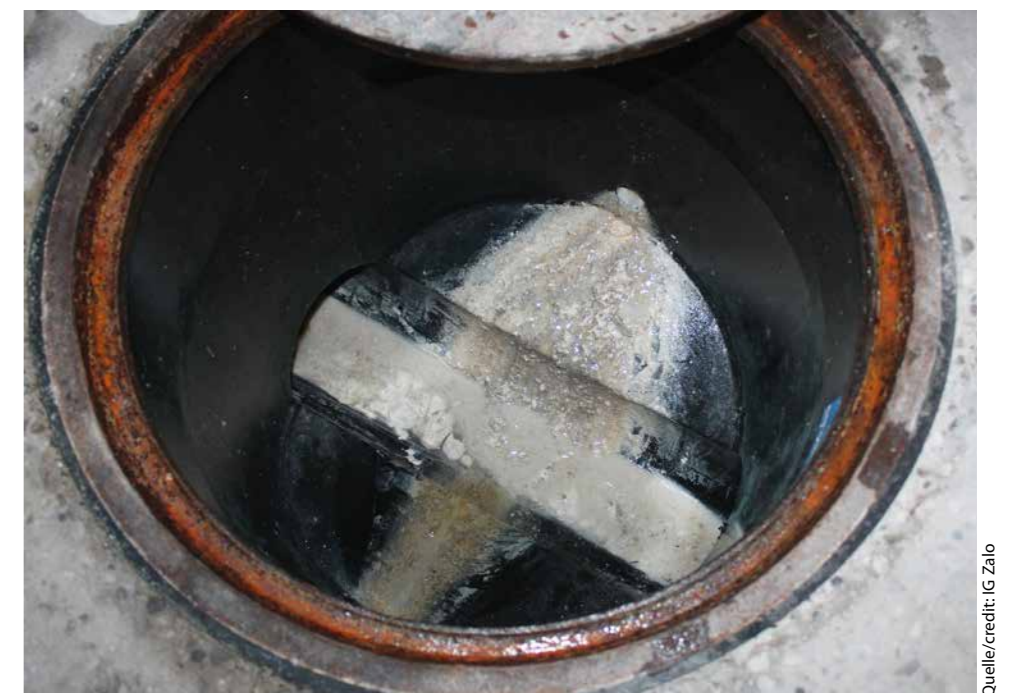
10 Versinterungen im Entwässerungsschacht FLRS Sintering in ERT drainage shaft
