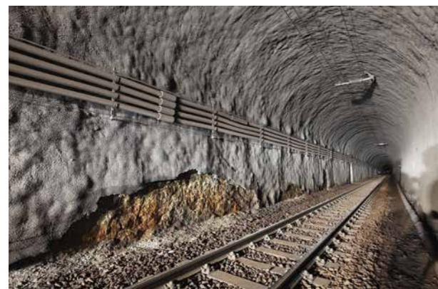
1 Schäden im bestehenden Albulatunnel Damage in the existing Albula Tunnel
