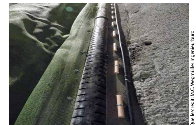
6 Einbau von Depotsteinen und des Rückführungssystems in die Sickerpackungen der Gewölbedrainagen beim Bau des Ceneri-Basistunnels. Installation of sustained-supply stones and the return feedback system in seepage packing for vault drainage in the construction of the Ceneri Base Tunnel.
