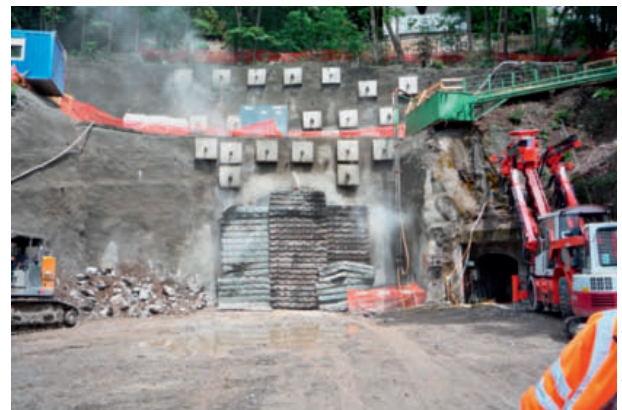
10 Photo du portail avec les deux fondations des piles du viaduc autoroutier lors d'un minage d'excavation de la galerie d'accès Photo of adit entrance during excavation blasting, with two pile foundations for the motorway viaduc
