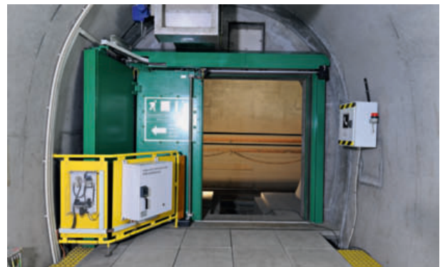
1 Querschlagtür im Gotthard-Basistunnel Cross-passage door in the Gotthard Base Tunnel
