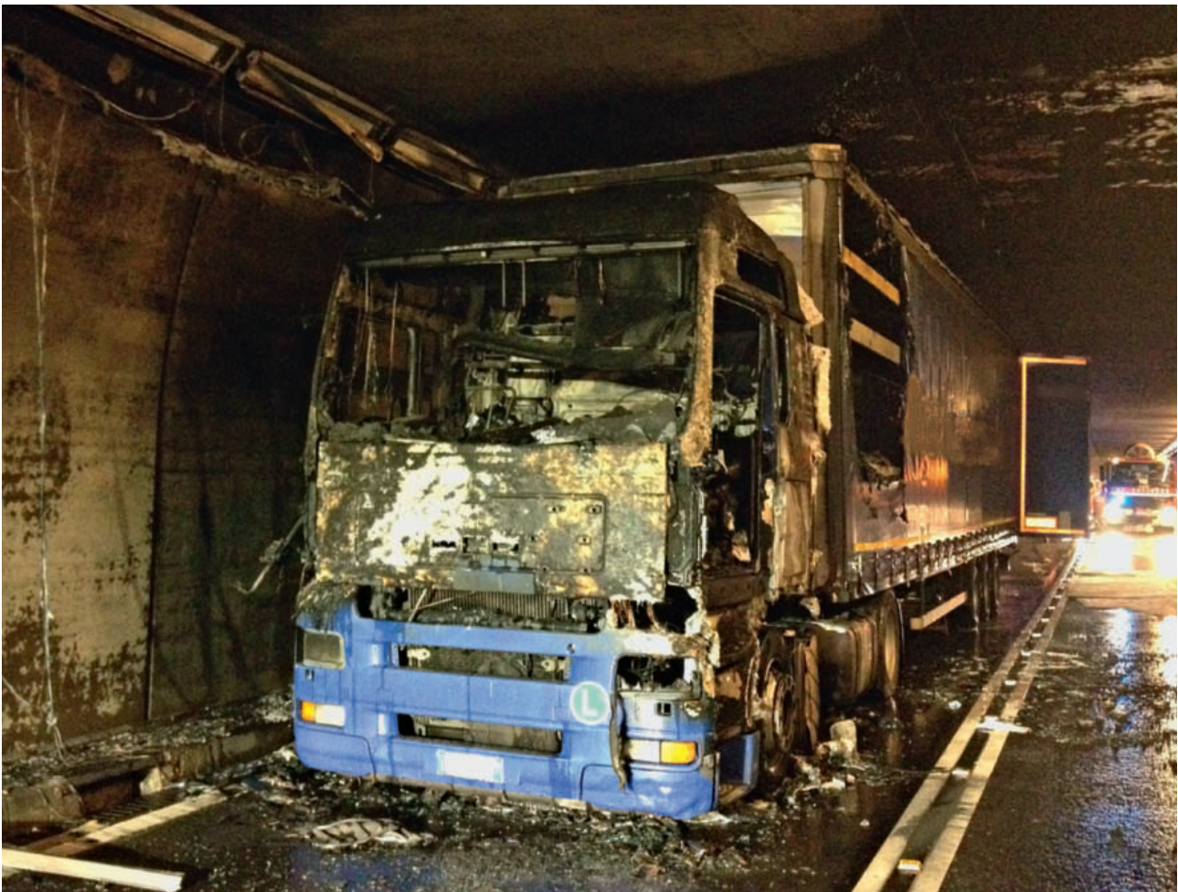
5 Lastwagenbrand 25. Oktober 2012 mit Schäden an der Infrastruktur Truck fire on Oct. 25, 2012 with damage to the infrastructure
