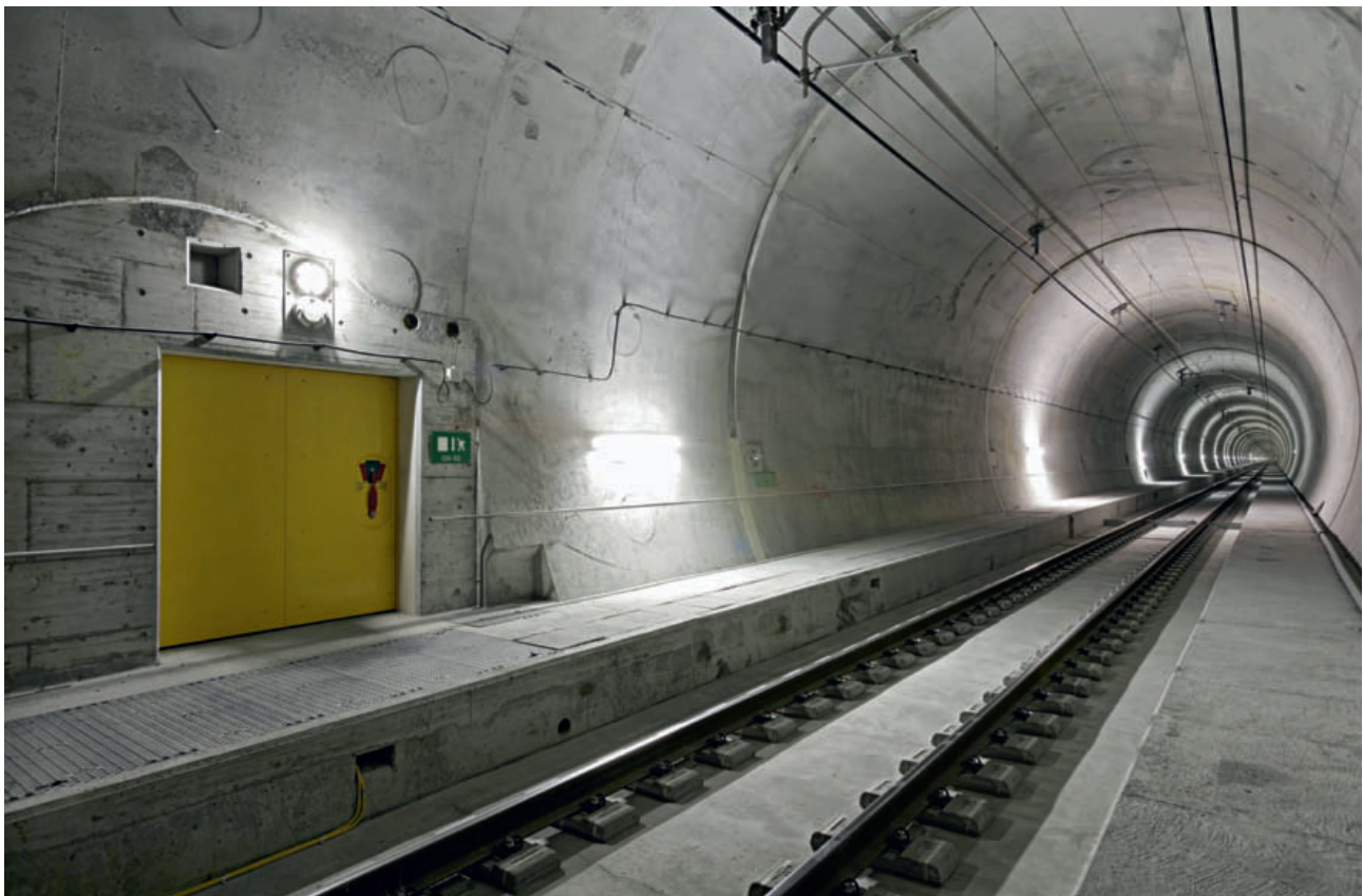
9 Querschlagtür im Lötschberg-Basistunnel Cross-passage door in the Loetschberg Base Tunnel
