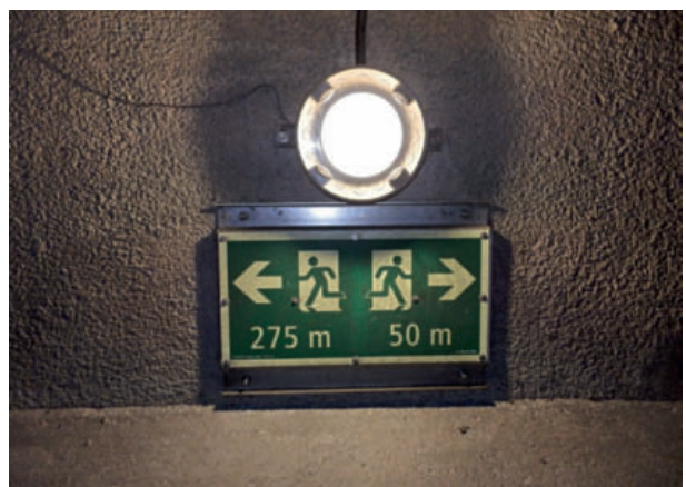
1 Notbeleuchtung und Fluchtwegbeschilderung Emergency lighting and escape route signage
