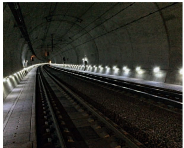
3 Notbeleuchtung integriert im Handlauf Emergency lighting integrated into handrail
