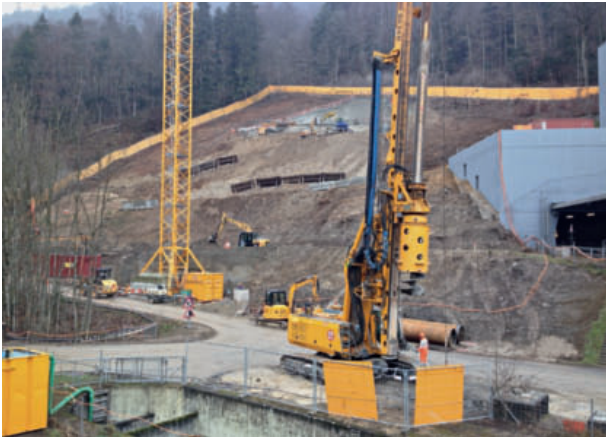
7 Überblick über die Aushubarbeiten für den Voreinschnitt Süd Overview of the excavation work for the south pilot cut
