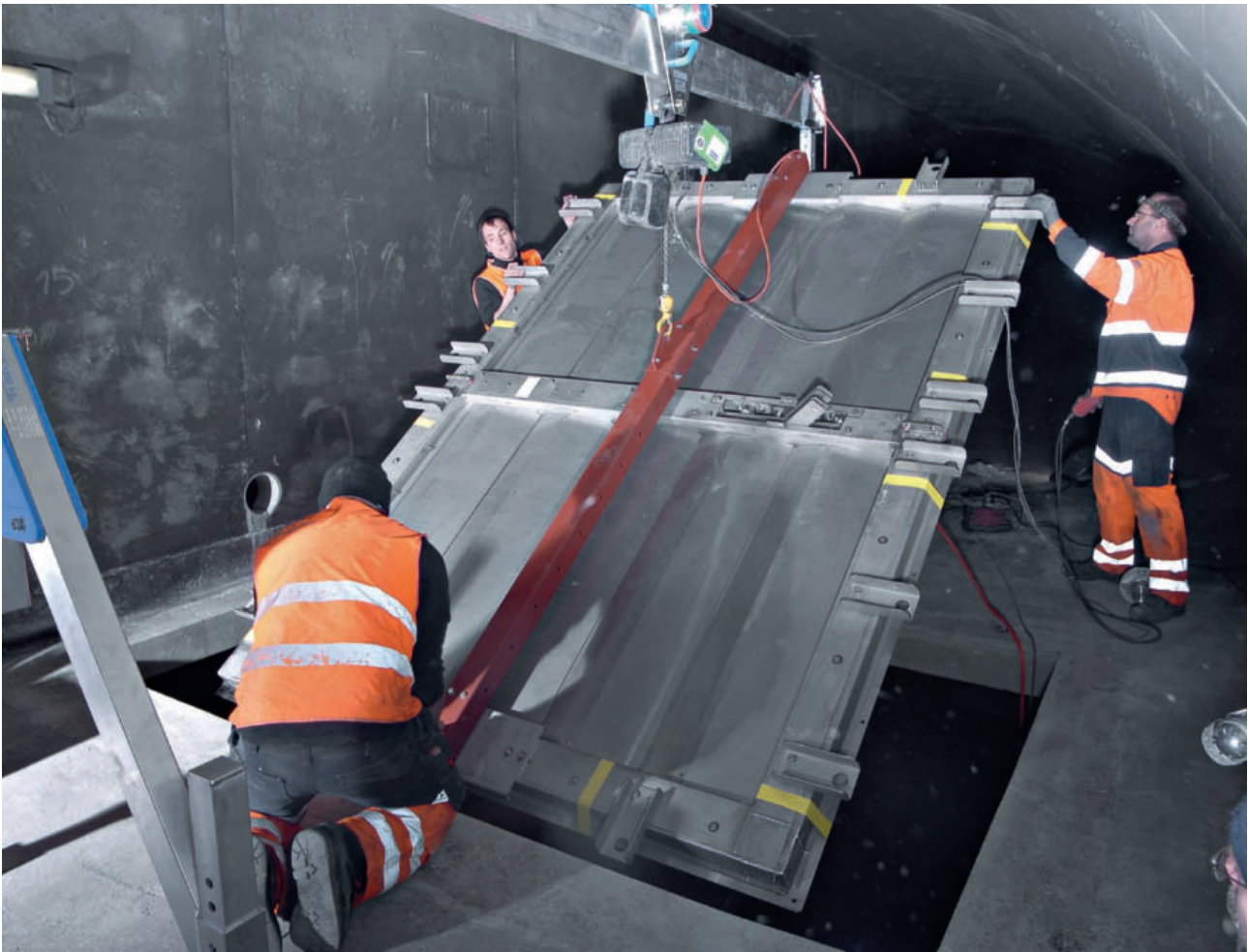
11 Einbau der Lüftungsklappen im Seelisbergtunnel Installing the ventilation flaps in the Seelisberg Tunnel
