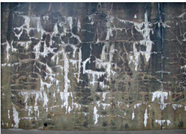
13 Rissbildung durch AAR AAR-induced cracking
