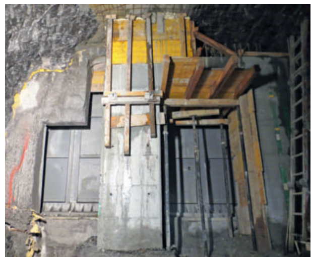
6 Betonarbeiten beim Anschluss einer Querverbindung an den Strassentunnel Concreting operations to connect a cross-passage to the road tunnel
