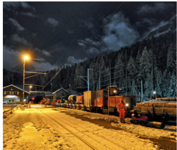
18 Nacht für Nacht fährt in dieser Bauphase ein Bauzug mit der gesamten Logistik in den bestehenden Tunnel und ermöglicht so, dass die Querverbindungen teilweise ausgebrochen und so für den Vortrieb des neuen Tunnels vorbereitet werden können. Die reine Bauzeit ist durch das enge Fenster der Nachtzugspause des Bahnbetriebs sehr beschränkt
