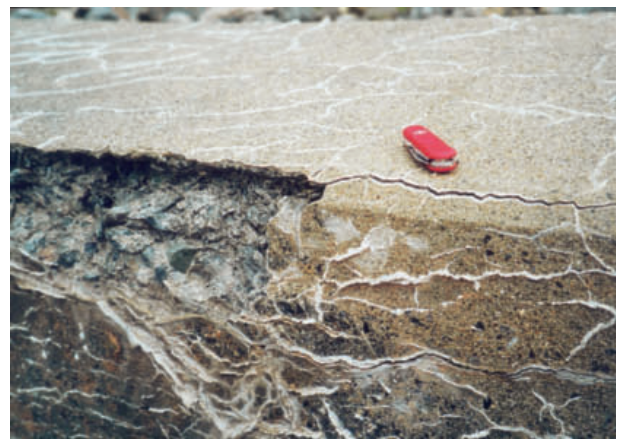
14 Zerstörung des Betongefüges durch AAR AAR-induced destruction of the concrete matrix
