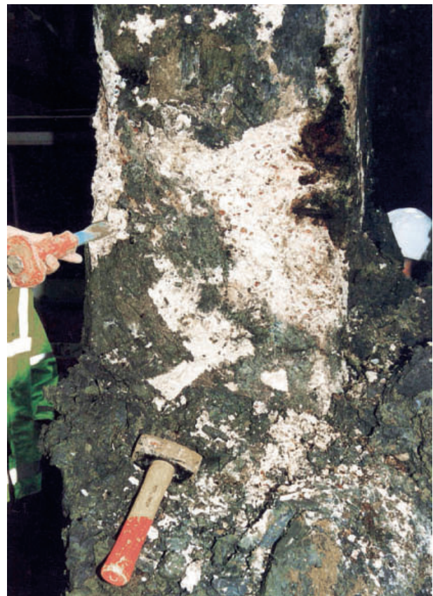
8 Zerstörung des Betongefüges durch Sulfatangriff Destruction of the concrete matrix by sulphate attack
