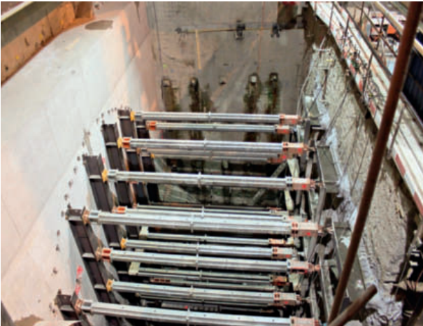
11 Injektionseinlagen und Spriessung für Annäherung TBM Grouting zones and propping for TBM approach
