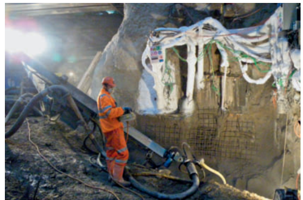
6 Schockgefrieren mit Flüssigstickstoff und Unterfangung mit Spitzbeton Shock freezing with liquid nitrogen and underpinning with shotcrete
