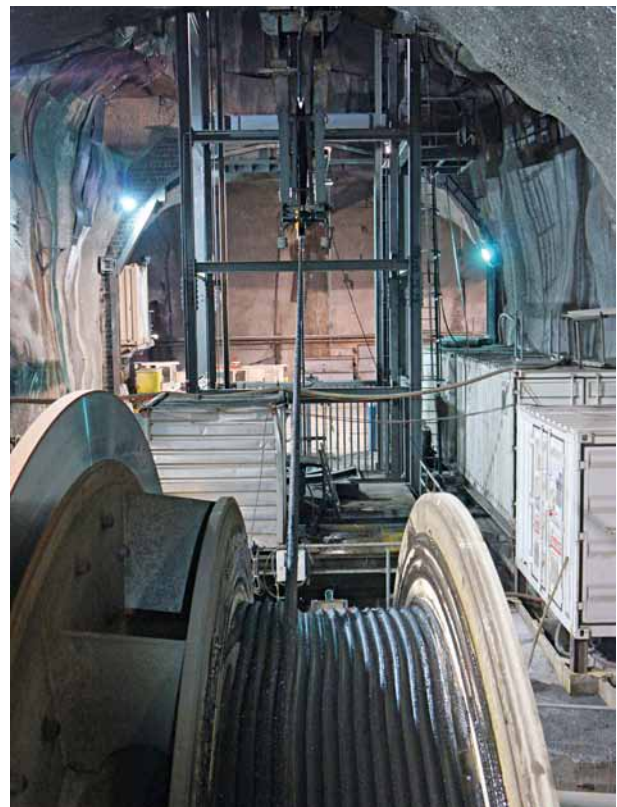
6 Fördermaschine Schacht 2 Conveyor system for Shaft II
