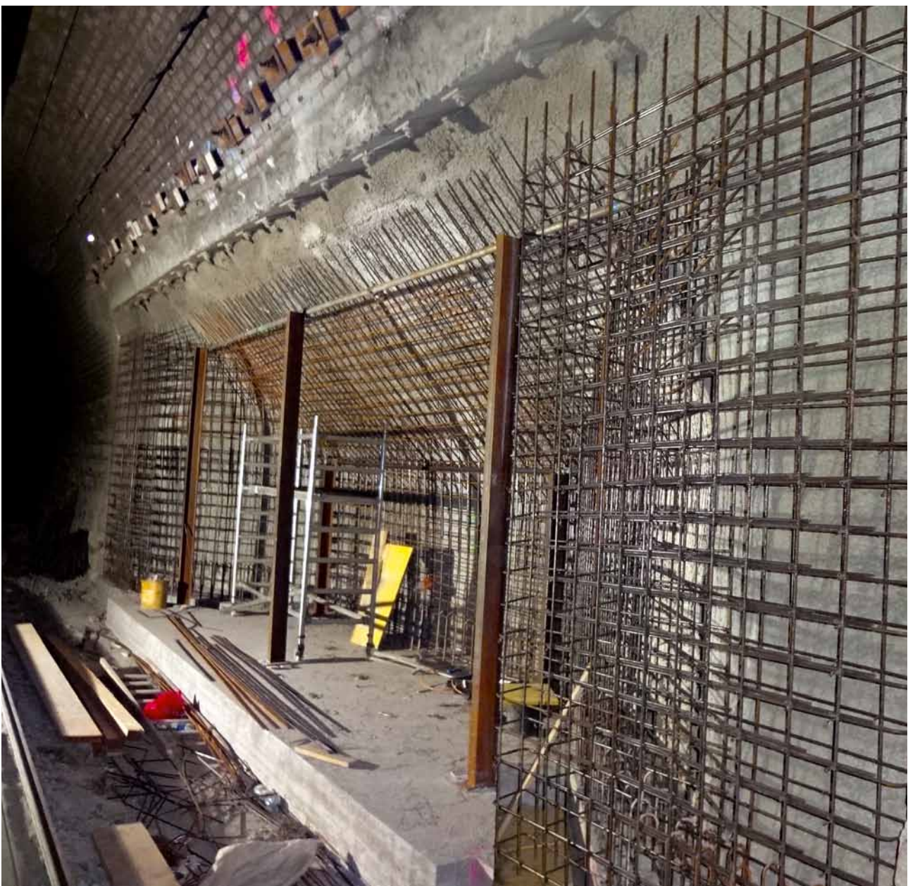
7 Ausgebrochene Muffennische 132 kV mit Gebirgssicherung und Einbau der Bewehrung für die Ortbeton-Verkleidung Excavated sleeve recess 132 kV with rock support and installation of the reinforcement for the in situ concrete lining
