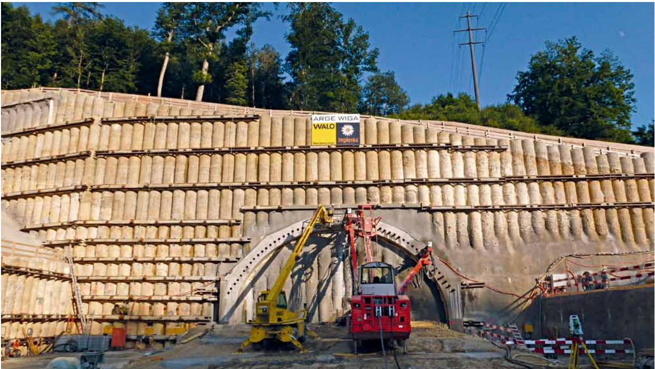
8 Portalriegel mit Rohrschirm am Portal Engi Portal bar with pipe umbrella at the Engi portal
