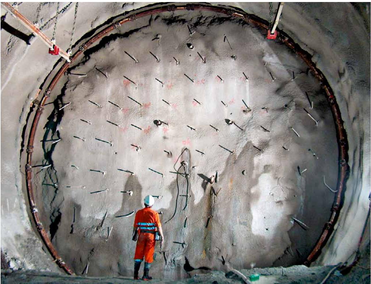
5 Ansicht eingespritzte Ortsbrust mit Ortsbrustankern View of sprayed face with face anchors
