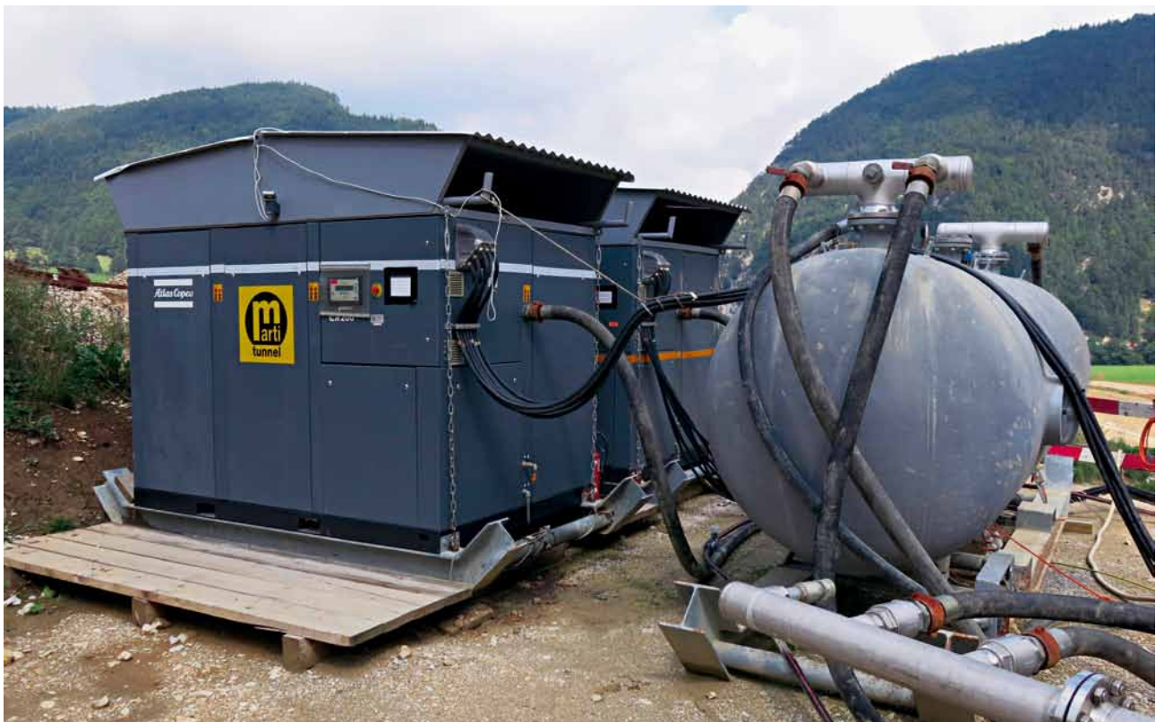
7 Kompressoranlage mit Windkessel Compressor system with pressurized tank
