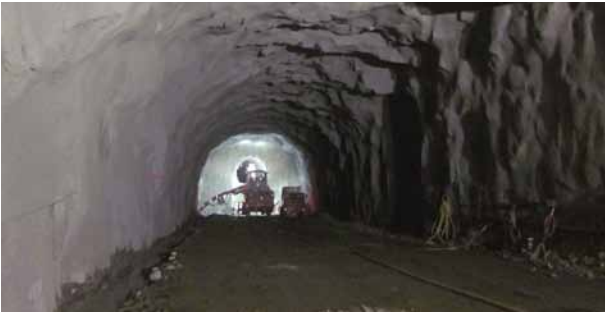
11 Geologisch bedingtes Überprofil Geologically provoked overbreak
