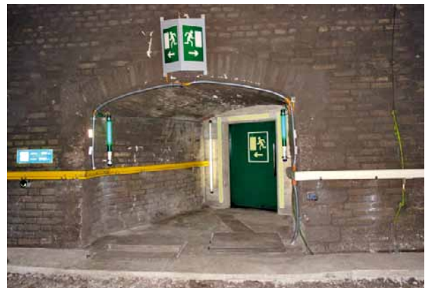
5 Als Muster ausgerüsteter Querschlag mit Türe, Beleuchtung, Beschilderung und zwei verschiedenen Typen des Handlaufs (Frühjahr 2011) Cross-passage equipped with door, lighting, signs and 2 different types of handrail for trial purposes (Spring 2011)
