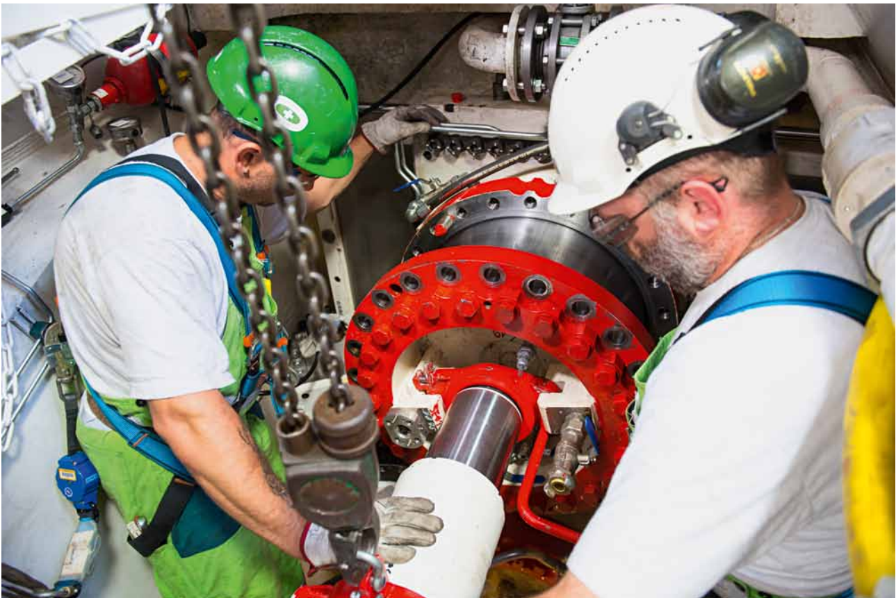
8 Test und Training für Schneidrollenwechsel innerhalb des Schneidrads während der Inbetriebnahme der TBM Disc cutter exchange test and training from inside the cutterhead during TBM commissioning
