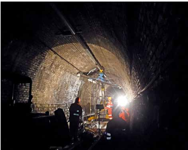
6b Bohren und Anker setzen bei der Simplontunnelsanierung Simplon Tunnel: drilling and placing anchors
