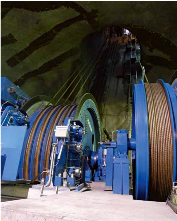
5 Fördermaschinen Schacht 1 Conveyor systems for Shaft I
