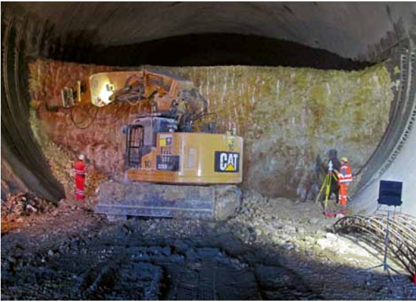
4 Maschinell unterstützter Vortrieb Strosse 3-Spurprofil Engi Mechanically supported drive for Engi 3-lane bench drive
