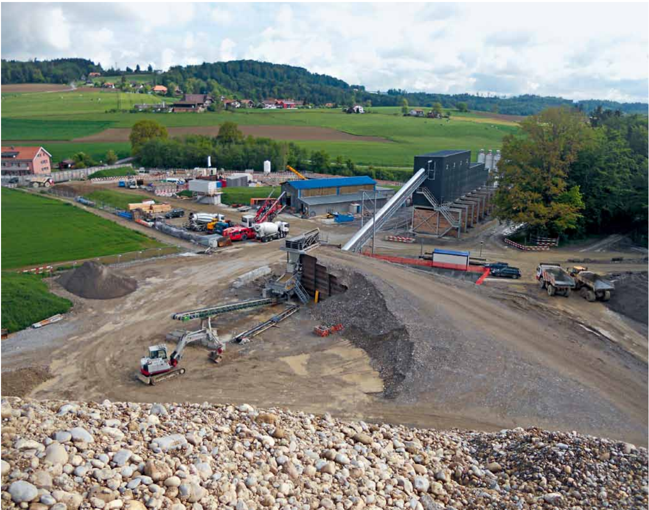
6 Kiesaufbereitung mit Betonzentrale Gravel preparation with concrete plant
