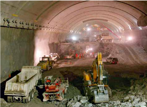
15 Vertiefung gleichzeitig zur Betonierung des Hängegewölbes Deepening simultaneously to concrete the hanging roof
