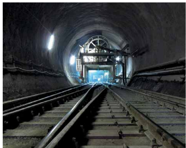
6 Faido – Doppelspur Gleisanlage mit Backup Wurm Faido – dual track system with back-up worm
