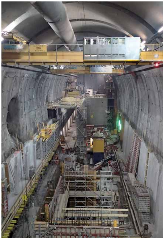
Pumpspeicherwerk Limmern, Trafokaverne
