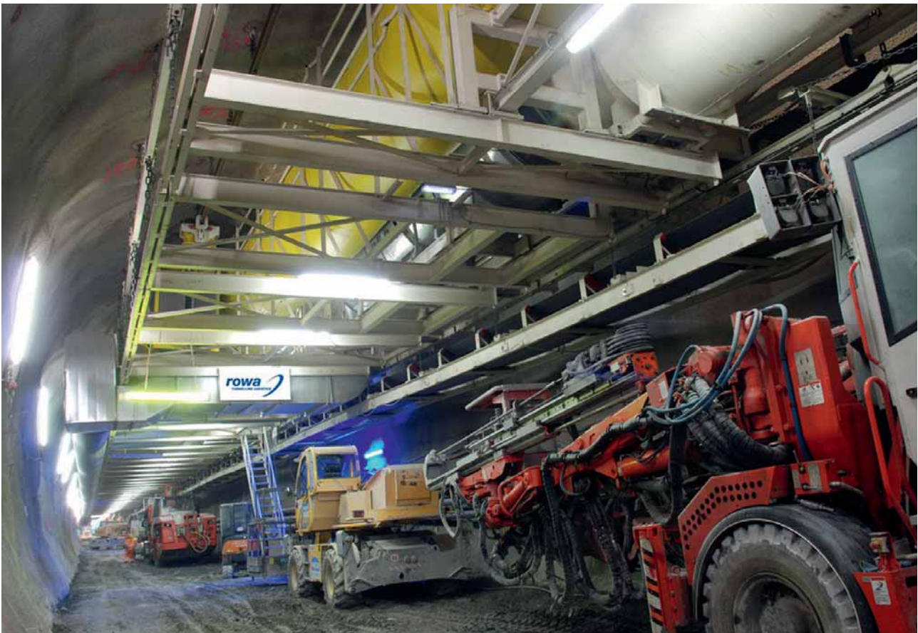
5 Rationalisierung der Arbeitsabläufe und höhere Arbeitssicherheit dank freiem Arbeits- und Parkraum unter der Vortriebsbühne Rationalization of work flows and increased working safety thanks to free floor space for working and parking
