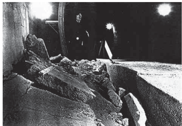
4 Durch Quelldruck zerstörtes Sohlgewölbe (1965) Base invert destroyed by swelling pressure (1965)
