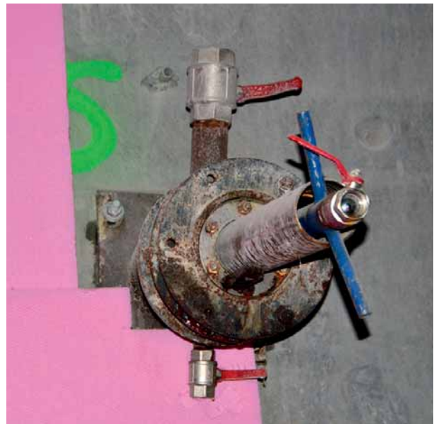
14 Eingesetzter Preventer für die Bohrungen der Gefrierlanzen Preventer used for drilling the freezing lances
