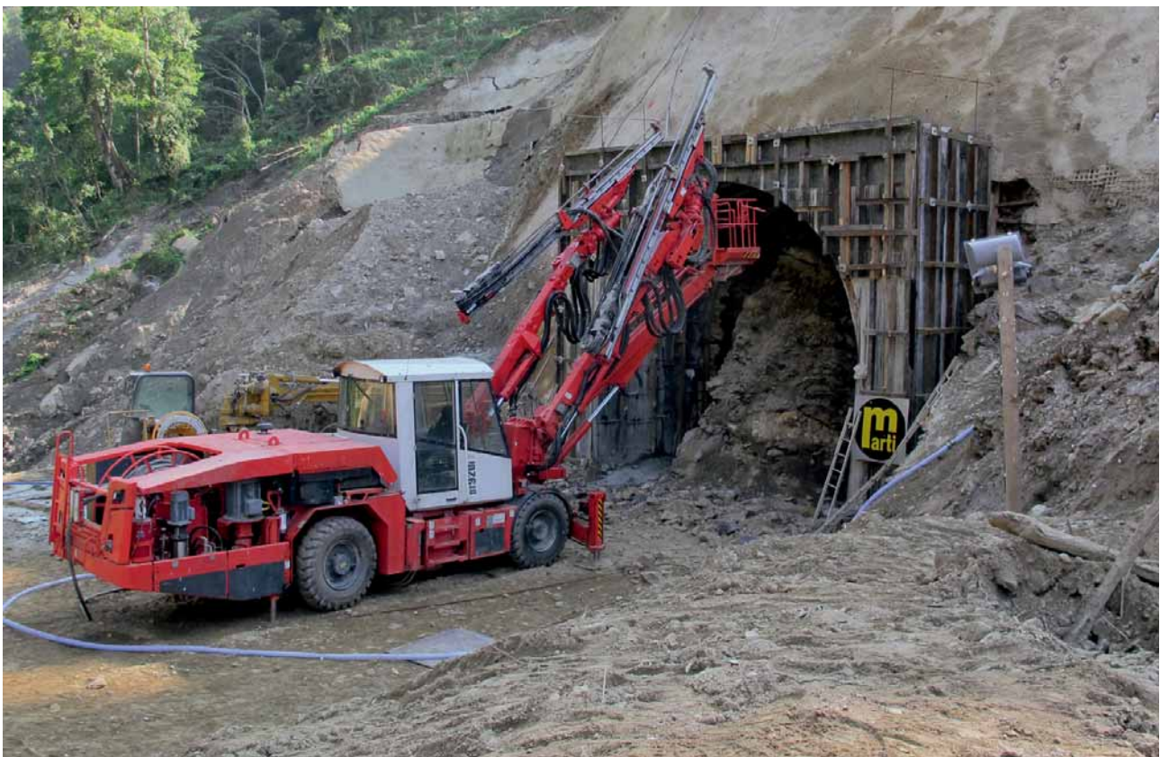
3 Am Portal des Adits 2: Beginn der Ausbrucharbeiten Adit 2 portal: start of excavation work
