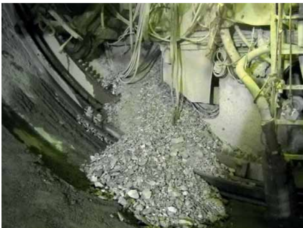
7 Niederbruch bei TKm 230,312 Cave-in at TKm 230.312
