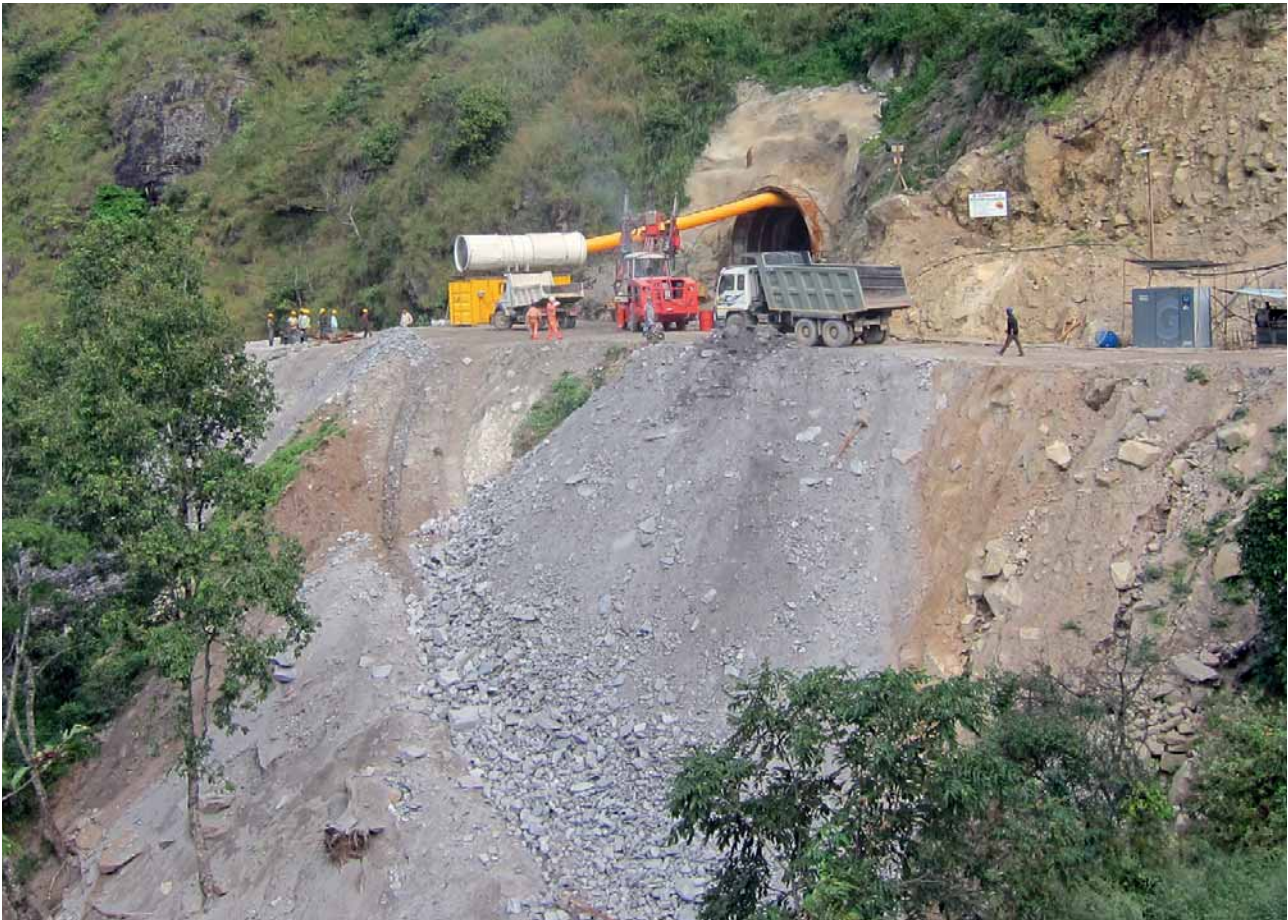
10 Adit 3: Schüttung der Installationsflächen durch Endlagerung des Ausbruchmaterials direkt vor dem Portal Adit 3: shoring up the installation yards through final storage of the excavated material directly in front of the portal
