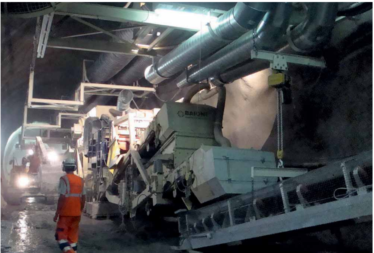
4 Teleskopierbare Ventilationsbühne für die optimale Frischluftzufuhr bis zur Ortsbrust und zur effizienten Spülung der Sprengschwaden Telescopic ventilation platform for optimal fresh air supply up to the heading face and for efficient suction ventilation of blasting fumes
