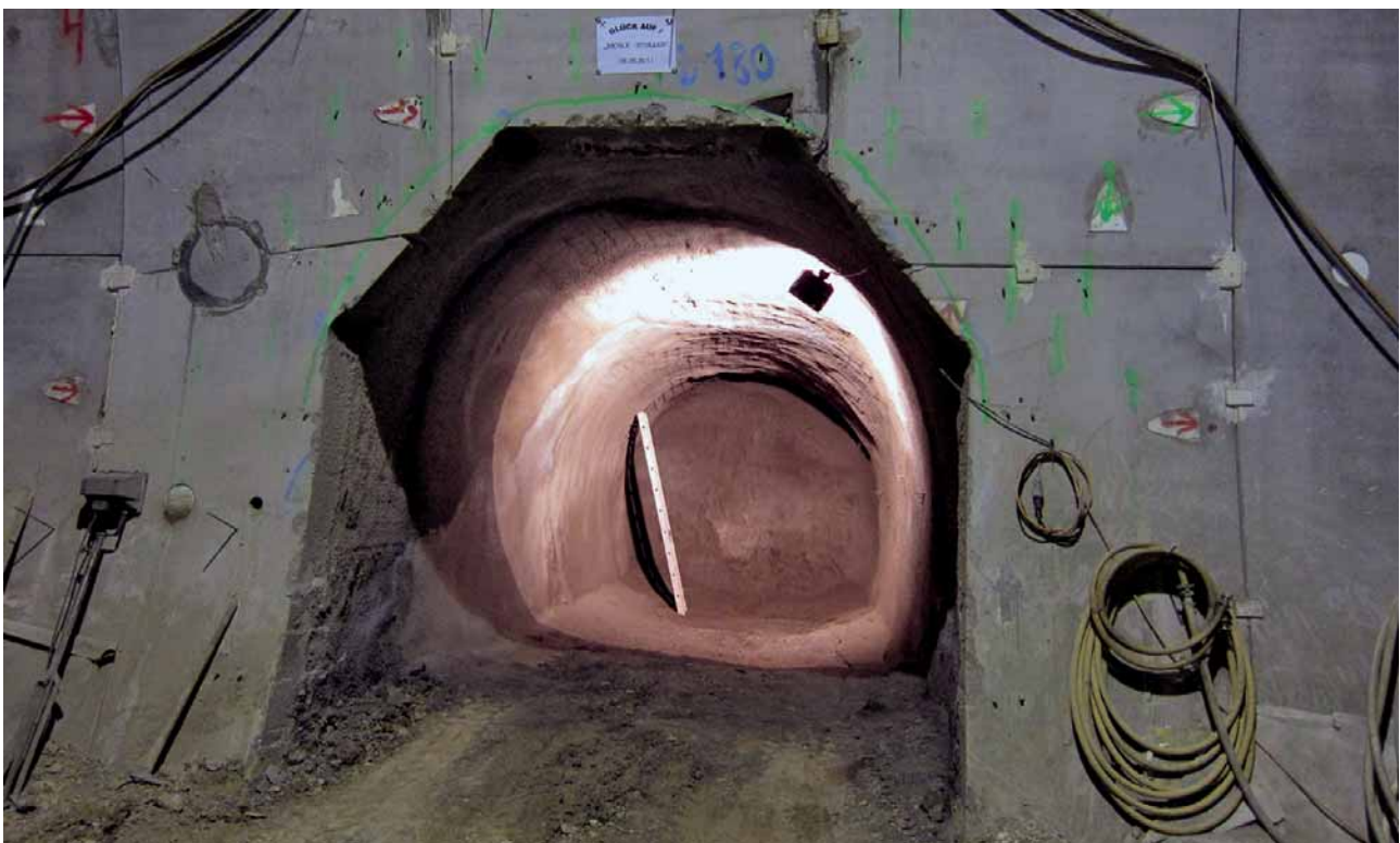
13 Tübbingsicherung bei einem befahrbaren Querschlag Securing the segments for a negotiable cross-passage
