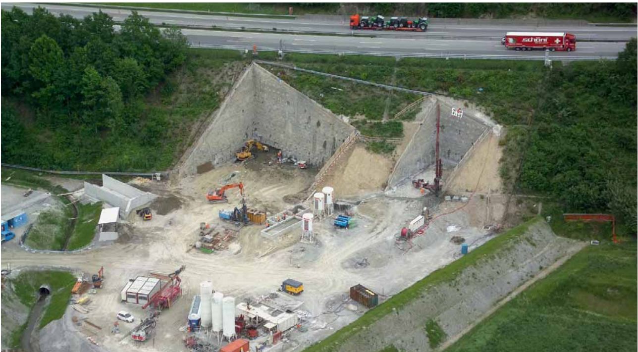
3 Baugruben zum Tunnelansatz für eingleisigen Eisenbahntunnel und Kaverne unter der Autobahn (Quelle: ATG) Construction pits for starting the single-track rail tunnel and cavern beneath the motorway (Source ATG)
