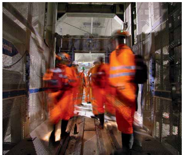
3 Sedrun – Förderkorb Schacht 1 Sedrun – shaft 1 hoisting cage
