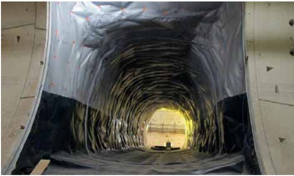
9 Etanchéité posée dans un rameau intertube Water proofing installed in the interconnecting tunnels
