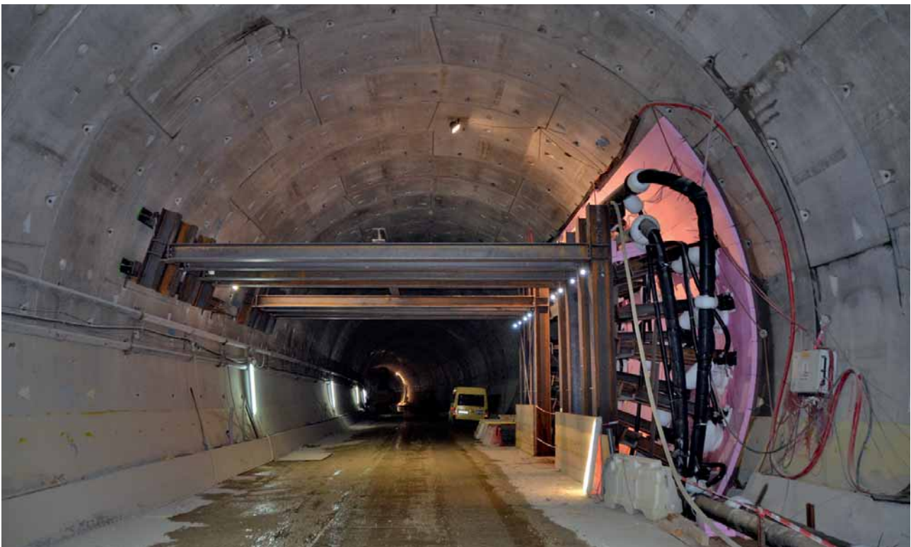
17 Stahlaussteifung zur Stabilisierung der Tunnelröhre infolge Aufbau des Gefrierdrucks einer Nische Steel bracing to stabilise the tunnel bore following build-up of freezing pressures in a niche
