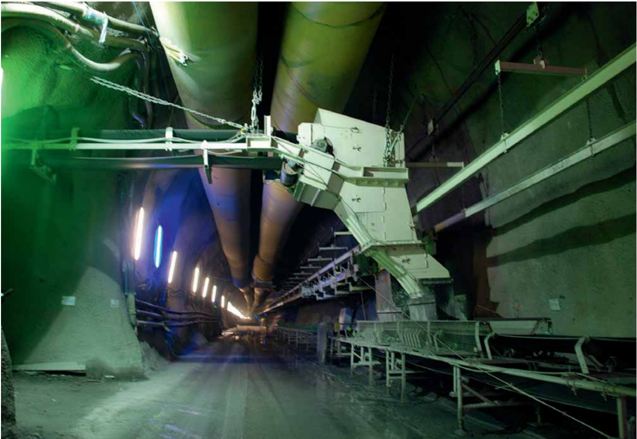
6 Übergabe des Ausbruchmaterials der Oströhre auf das Streckenband in der Weströhre Cross conveyor drops the excavation material from the eastern tube into the continuous conveyor in the western tube
