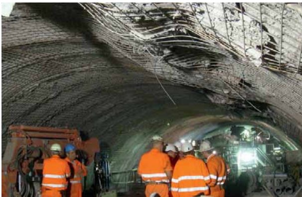
1 Grössere Deformationen im Nachläuferbereich des Teilschnitts Faido Major deformations in the back-up area in the Faido section
