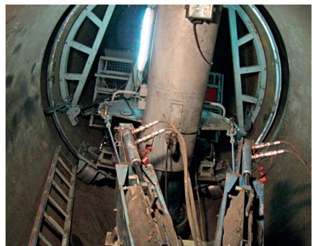
7 Rohrtransportwagen, der bei den Arbeiten in Cleuson-Dixence zum Einsatz kam Pipe carrier which was used during the work at Cleuson-Dixence
