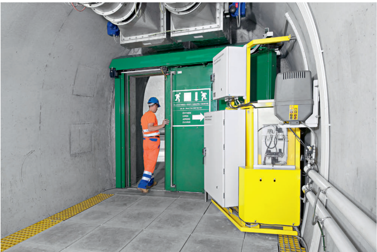
8 Mit RBA fertig ausgerüsteter Querschlag Cross-passage completely equipped with RBA (Quelle/Source: AlpTransit Gotthard AG)
