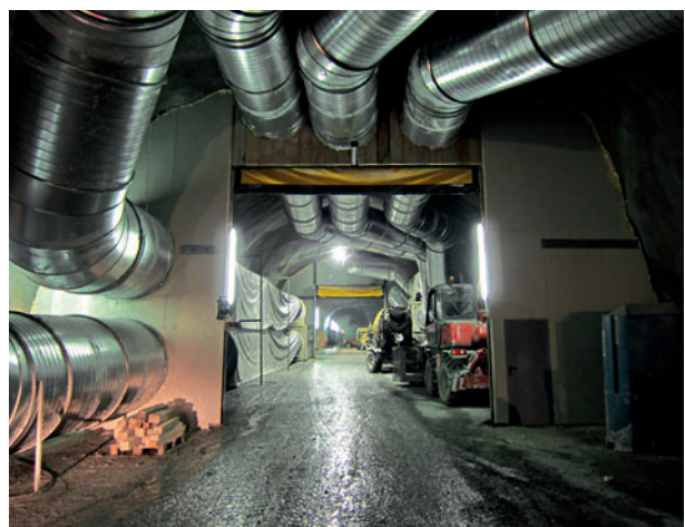
8a+b Lüftungszentrale unter Tag Underground ventilation centre
