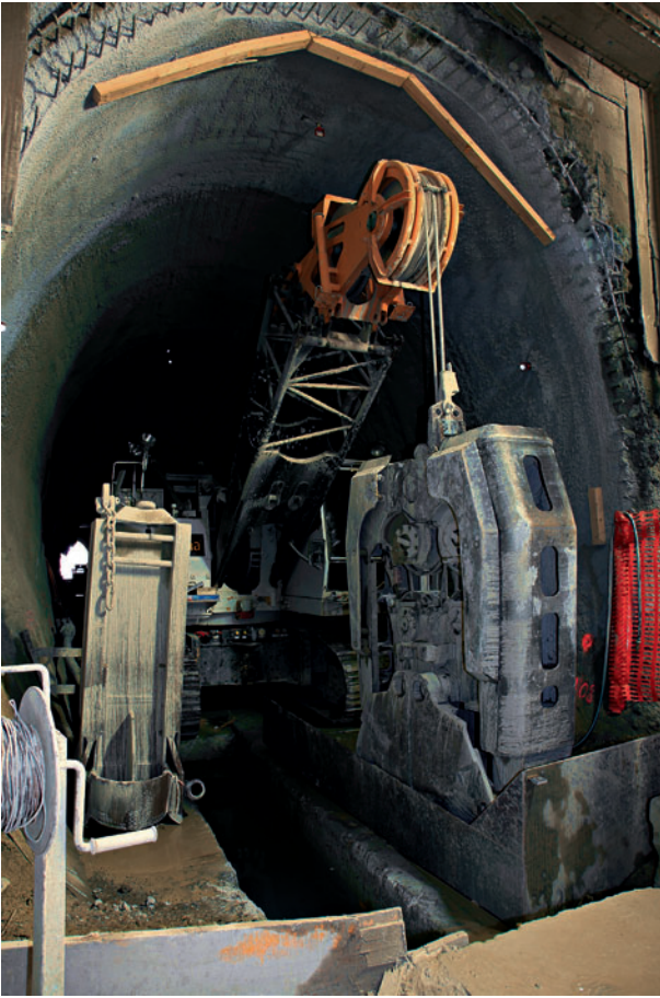
10 Erstellen der Schlitzwand aus den Längsstollen Producing the diaphragm wall from the longitudinal heading
