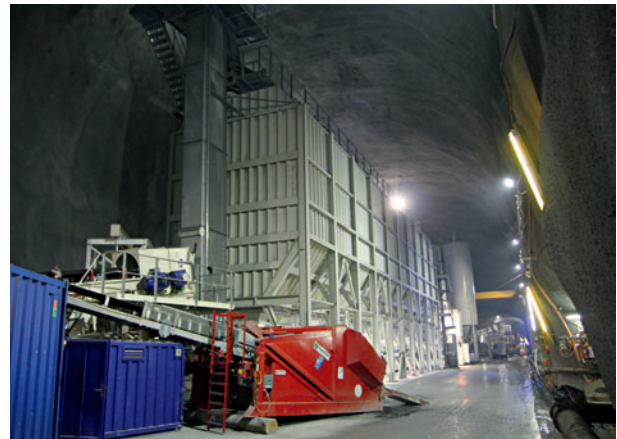
5 Betonanlage unter Tag Underground concrete plant
