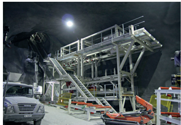
6 Montage-Übergabebereich zu Schrägförderband Assembly transfer area to inclined belt conveyor
