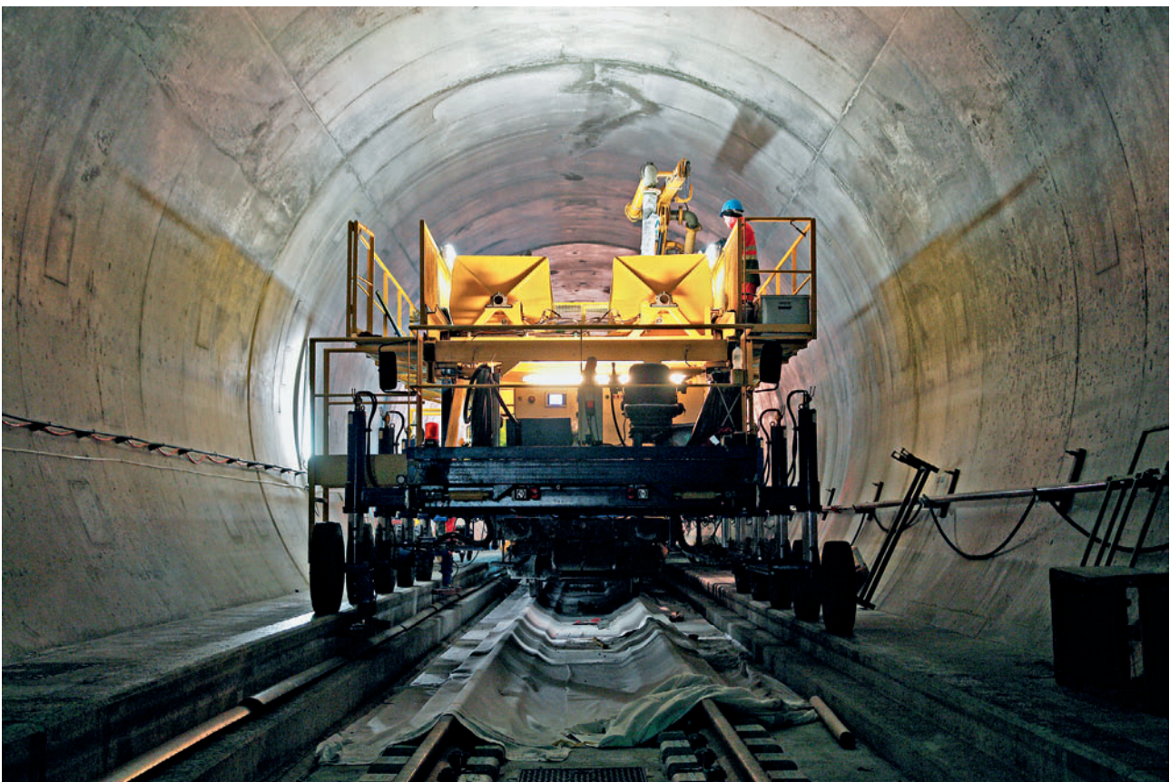
11 Das Betonshuttle fährt auf dem Tunnelbankett The concrete shuttle runs along the side of the tunnel (Foto/Photo: TTG)
