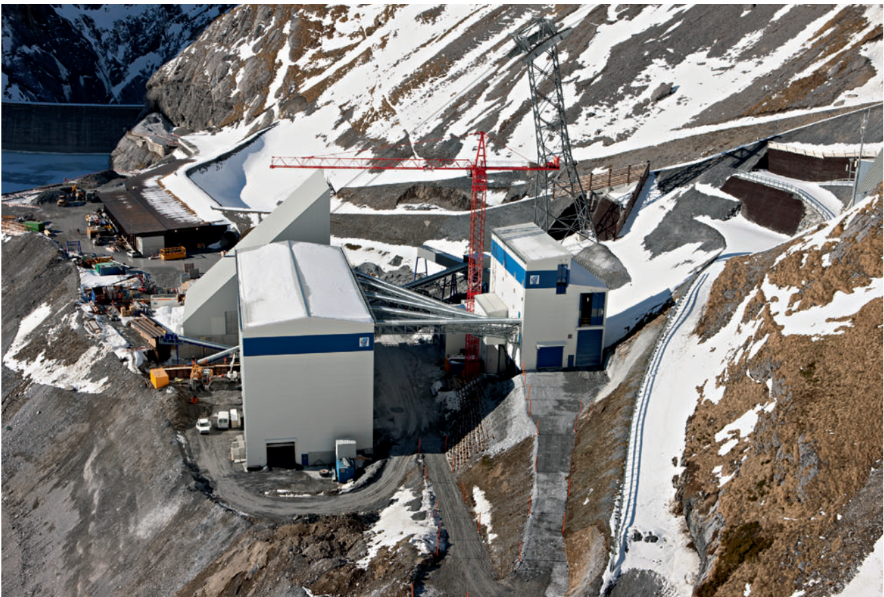
4 Installationsplatz über Tag bei engen Verhältnissen Installation yard on the surface with constricted conditions
