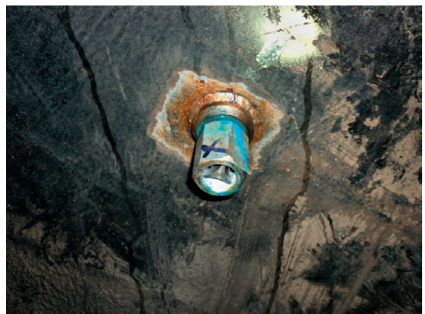
6 Einwegdruckentlastungsventil im Druckschacht Belleplace der Kraftwerke Emosson One-way relief valve in the Belleplace pressure shaft of the Emosson power plant (Quelle/Source: Soudant, March/März 2010)
