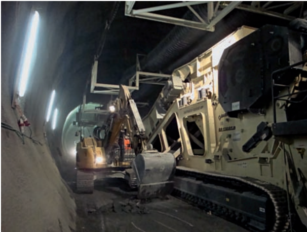
10 Teleskopierbare Ventilationsbühne für die optimale Frischluftzufuhr bis zur Ortsbrust und zur effizienten Spülung der Sprengschwaden (Ceneri-Basistunnel – Los Sigrino) Telescopic ventilation platform for optimal fresh air supply up to the heading face and for efficient suction ventilation of blasting fumes (Ceneri Base Tunnel – Sigrino section)
