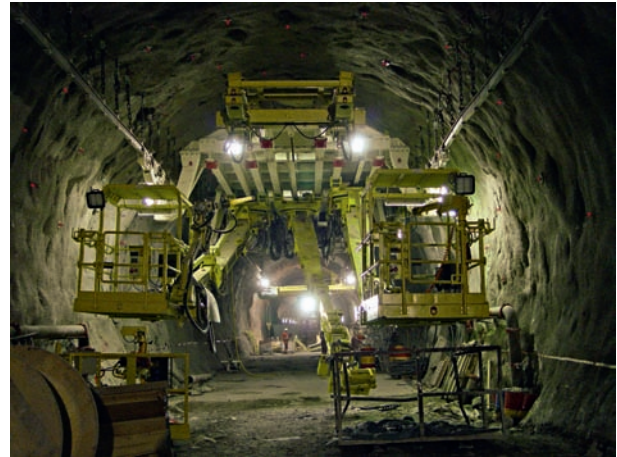
11 Streckenausbaumaschine mit Arbeitskörben, Versetzarml und Spritzbetonmanipulator (Gotthard-Basistunnel – Los Sedrun) Machine for rock support with working baskets, setting arm and shotcrete manipulator (Gotthard Base Tunnel – Sedrun section)
