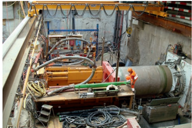
6 Vortriebsinstallation Grossrohrschirm im Schacht Südtrakt Tunnelling installation and pipe arch in the South Station Zone shaft
