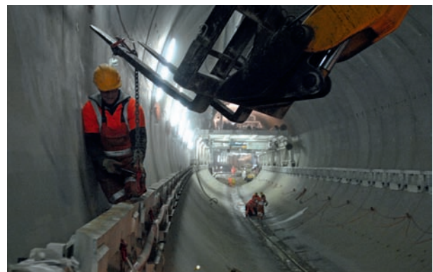
6 Die Arbeiten gehen voran: Der Weinbergtunnel als wichtiges Teilstück der DML in Zürich Work continues: the Weinberg Tunnel, an important element in Zurich Cross Rail Quelle/Source: SBB
