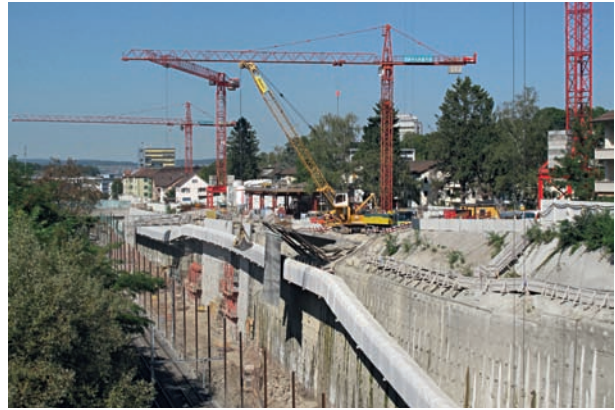
9 Bandförderung zwischen Portal und Installationsplatz Oerlikon Belt conveyance between the portal and the Oerlikon work yard
