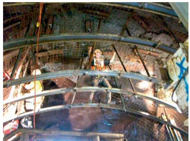
5 Überprofil im „Queenston Shale“ Overbreak in “Queenston Shale”
