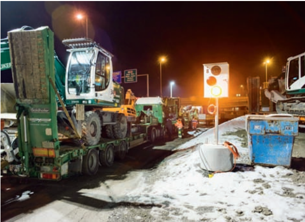
10 An der Signalampel aufgereihter Baustellenkonvoi auf dem Installationsplatz Schlund Site convoy arrayed at the "start light" at the Schlund work yard
