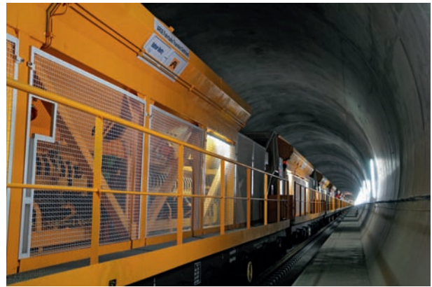
8 Der Betonzug im Einsatz im Tunnel, im Vordergrund der Kieswagen The concreting train in use in the tunnel, showing the aggregate car in the foreground
