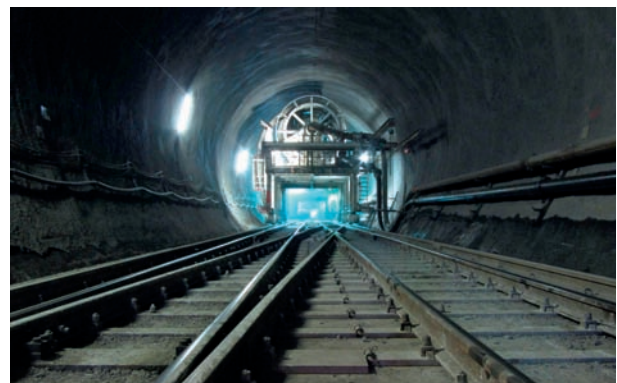
9b Schlauchportal „Wurm“, Front-Satellit The “worm” hose portal, front satellite
