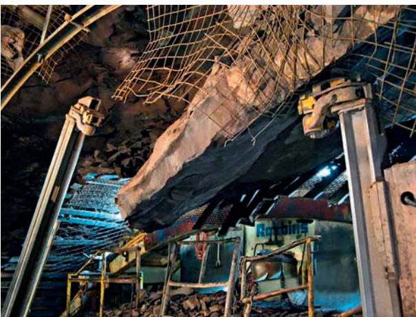
4 Nachbrüche aus der Firse – Station 0+839 Block failure – Station 0+839
