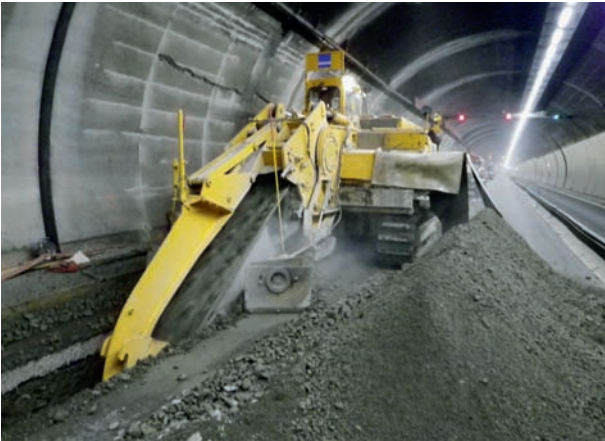
12 Ausbruch des Grabens der Längsentwässerung mit einer Grabenfräse Excavating the drainage-system trench using a trench cutting machine
