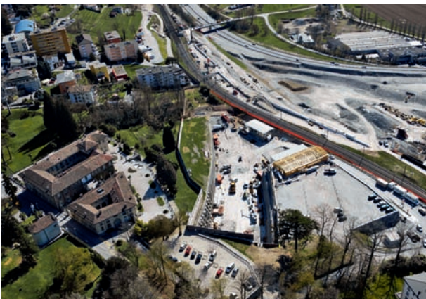
2 Übersicht Baustelle mit Villa Negroni (links) oberhalb des Voreinschnittes Site overview, showing the Villa Negroni (left) above the pilot cut
