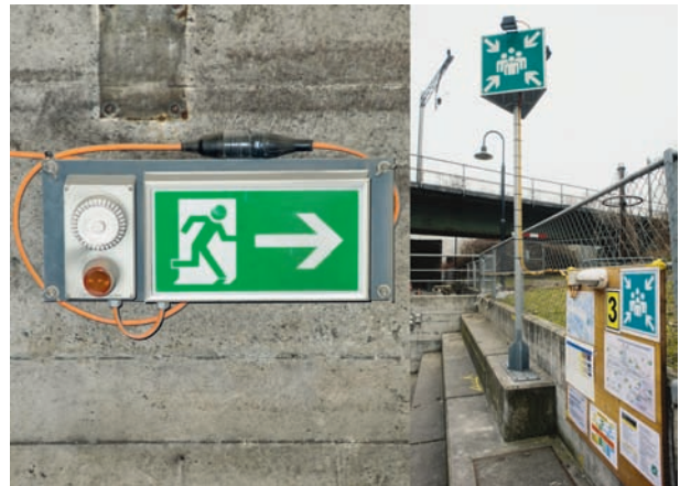
9 Die Alarmierungseinrichtungen (links) führen die Personen zu den Sammelplätzen (rechts) The alarm systems (left) guide persons to the assembly areas (right)
