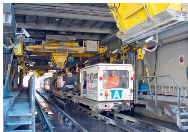
3b Betonzug beim Verlad unter der Betonanlage Bodio Concreting train being loaded under the concrete chute at Bodio
