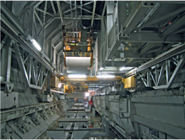
3 Automatisierter Umschlag der Tübbinge vom Bahnhofsbereich bis zum Tübbingmagazin bei gleichzeitigem Betonumschlag für den Sohleinbau (Wienerwald-Tunnel) Automated lining segment transfer from supply train to lining segment storage, with simultaneous concrete transfer for invert construction (Wienerwald Tunnel)
