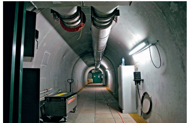
6 Querschlag mit Lüftung Transverse gallery, showing ventilation system
