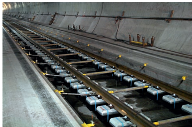
7 Fahrbahneinbau im Abschnitt Bodio West: Präzise ausgerichtete Schwellen und Geleise vor der Betonage Installation of track in the Bodio West section; precisely aligned sleepers and rails prior to concreting
