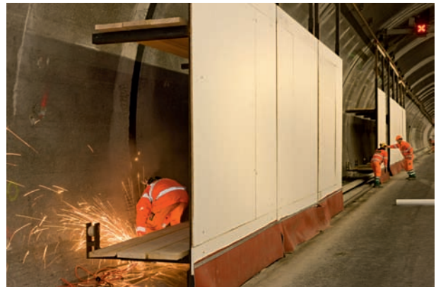
13 Verschiebbare Klimawand im Reussporttunnel Movable climatic wall in the Reussport Tunnel
