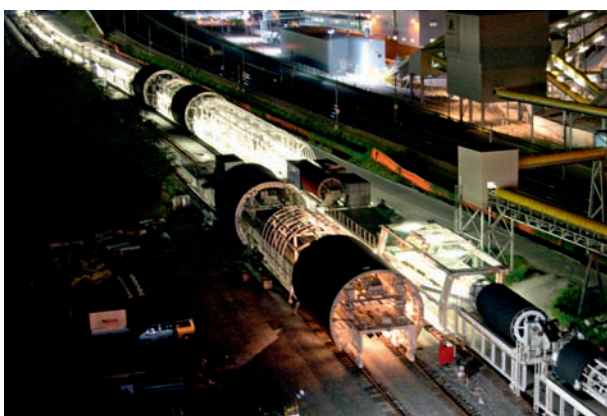
6 Montage der „Würmer“ auf dem Installationsplatz in Bodio (Nachtaufnahme) Assembly of the “worms” at the Bodio work yard (night photo)
