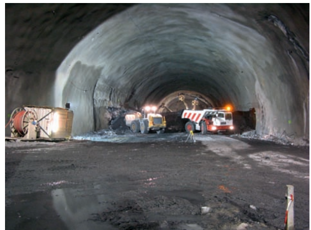
8 Ausbruch Strosse in der Verzweigungskaverne Süd Bench excavation in the south branch cavern
