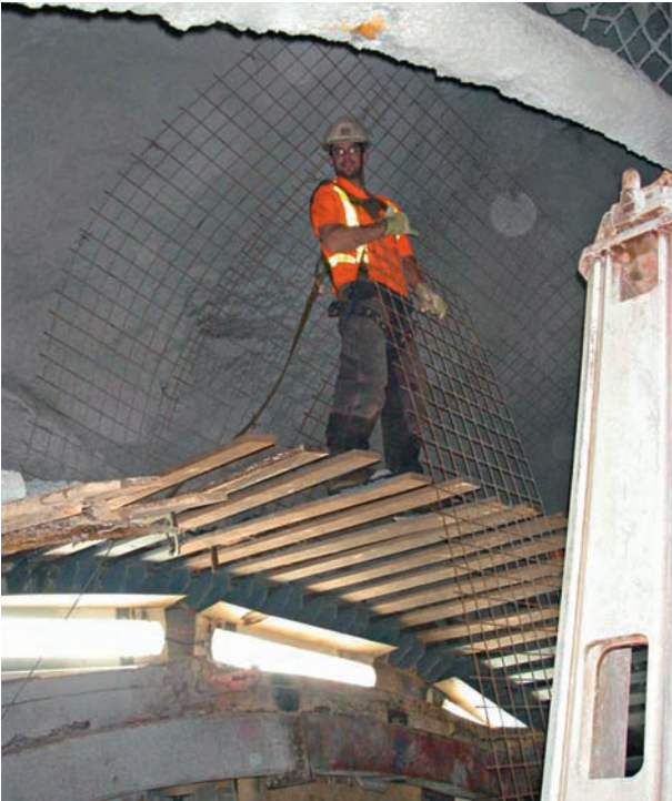
6 Verbruch im „Queenston Shale“ Downfall in “Queenston Shale”
