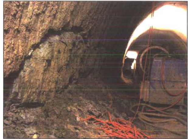
Photos 1 et 2: Altération des marnes travaux de purge et de consolidation
