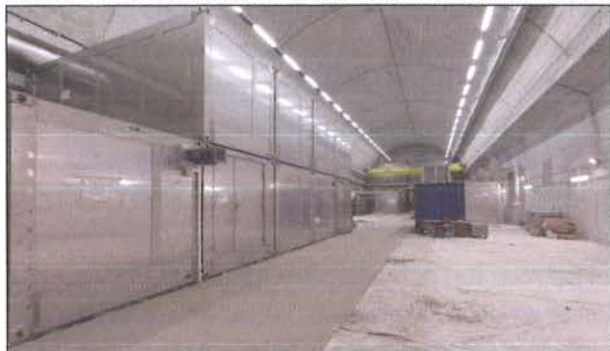
Bild 12: Die in Bern montierten und ausgetesteten Edelstahlcontainer im Verbund in der Betriebszentrale Mitholz.
