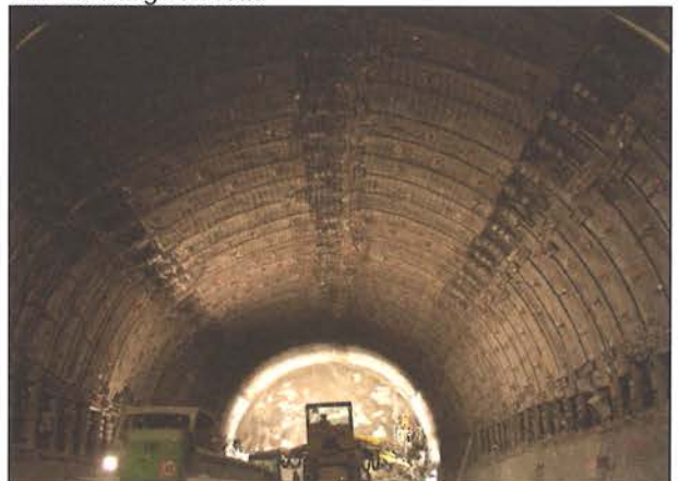
Bild 5: Deformationsschlitze im Bereich mit Stahlbogeneinbau
