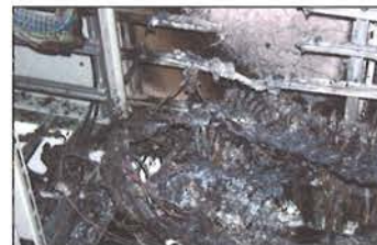
Bild 10: Brandschaden an einem Schaltschrank
