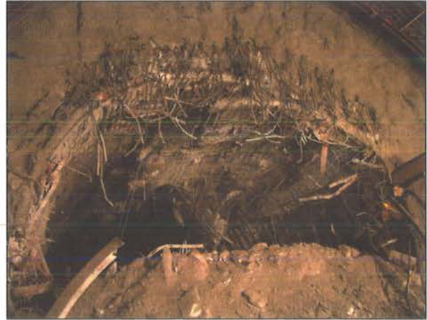
Bild 9: Aufweitung des konvergierten Bereiches im EST West-Nord
