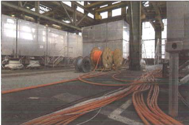
Bild 12: Die fertig ausgerüsteten Bahntechnik-Container im Systemtest
