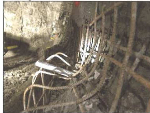
Bild 4: Deformation in den Schlitzen mit ausgebeulten Netzen
