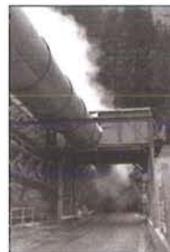
Bild 12: Der Zuluftventilator und ausströmende Abluft im Portalbereich Mitholz
