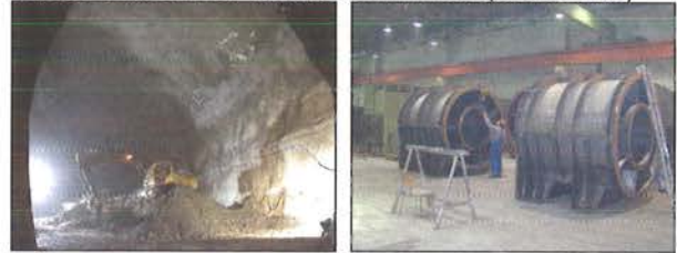
Bild 20: Lüftungszentrale Ferden in der Rohbauphase (linkes Bild). Gehäuseteile der beiden Zuluftventilatoren in Ferden während der Fabrikation im Werk (rechtes Bild)
