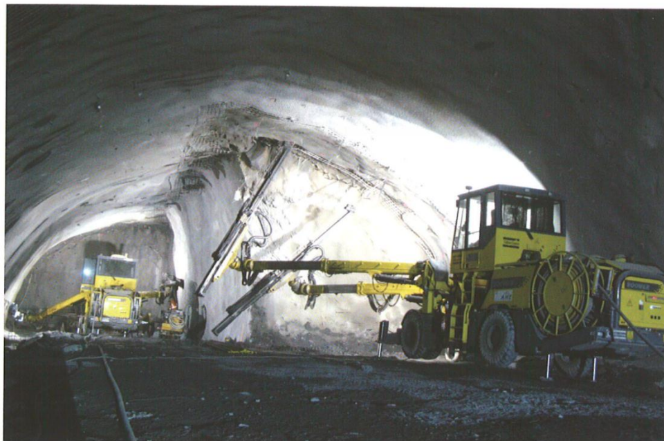
Photo 4 : Tunnel de Eyholz, contournement autoroutier de Viège / Eyholz Tunnel der Umfahrung Visp
