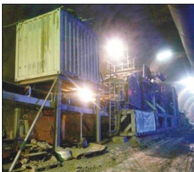
Unterirdischer Steinbrecher für die Zerkleinerung des Ausbruchsmaterialies für den Abtransport auf Förderband
